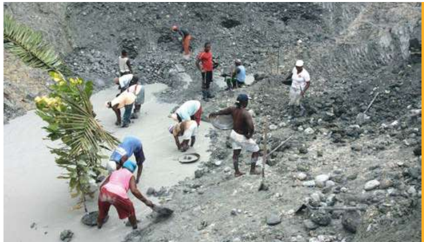
Barequeros y barequeras trabajando en la base de un talud que está en ángulo negativo y puede derrumbarse. Quebrada Las Ánimas, Tadó, Chocó. © WWF / C. Echavarría, 2016.
